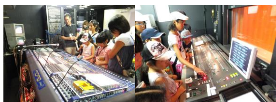
音響卓（音響室） 調光卓（調光室）
